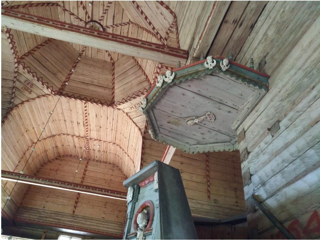
Kirkon sisätiloissa sileiksi piilutut hirsiseinät, puurakenteiset holvikatot ja kalusteet, kuten veistoksin koristeltu saarnastuoli, muodostavat tunnelmaltaan ainutlaatuisen kokonaisuuden.
